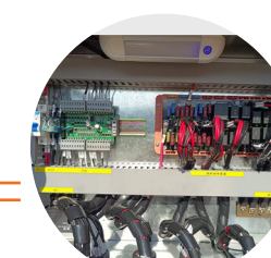
Manutenção centralizada dos painéis de controle elétricos
